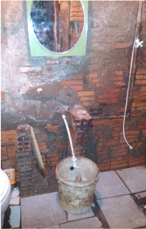
Situação do banheiro anterior a intervenção do PPMC/PAC.
