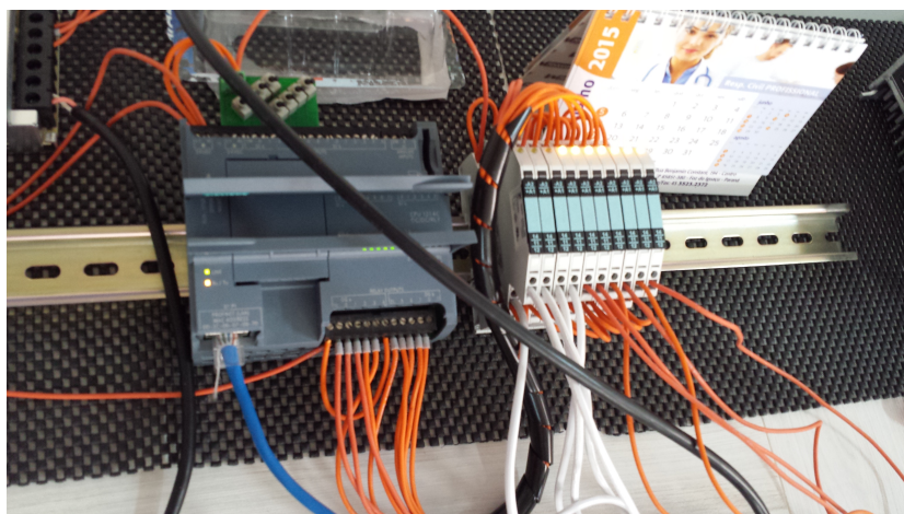
Figura 5.1.1 – CLP SIMATIC S7-1200 e relés encaixáveis devidamente montados sobre um trilho DIN.
