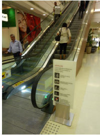
Figura 19: Informação adicional / sinalização REGULAMENTADORA e informação da arquitetura / a partir do OBJETO. O totem de informação estabelece como utilizar a escadaria rolante. Que é um elemento de destaque no ambiente.
