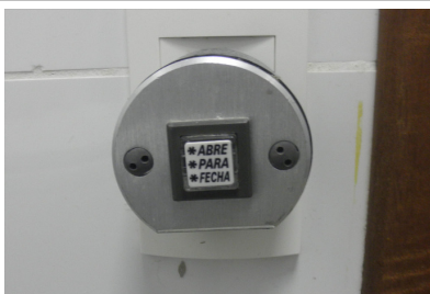
Figura 116: Identificação do botão localizado ao lado das bacias sanitárias nos sanitários adaptados de difícil compreensão.
