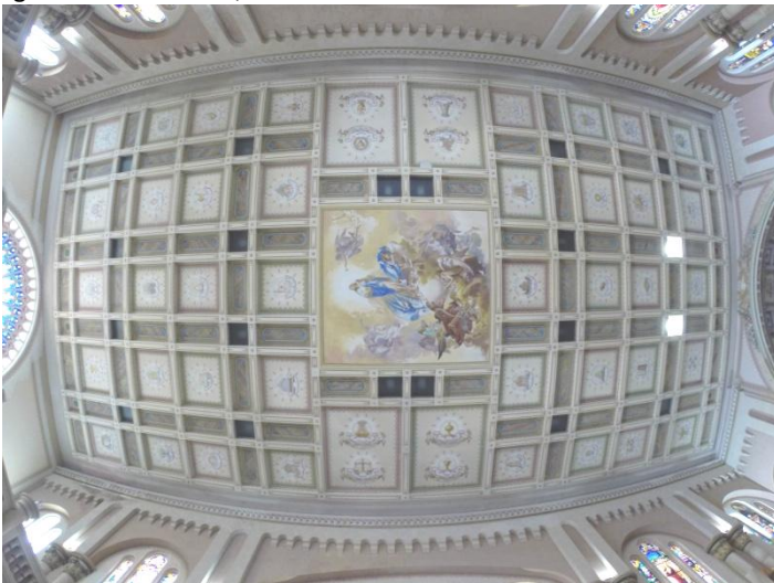
Figura 73: foto das pinturas no forro. A direita está o altar-mor e a esquerda a entrada. Fonte: Autora, 2016.
