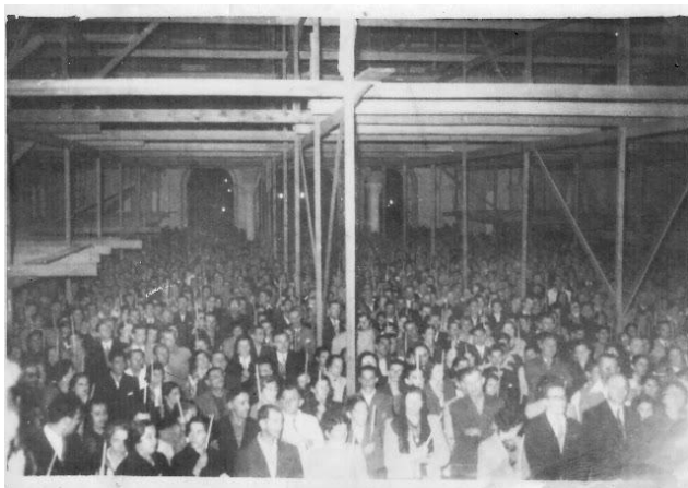
Figura 52: Celebração dentro da Igreja, que estava com os andaimes posicionados para a colocação do forro. Fonte: < http://clubedosentasitajai.blogspot.com.br/2013/02/construcao-da-igreja-matriz-vi.html >. Acesso em: 08 set. 2015.
