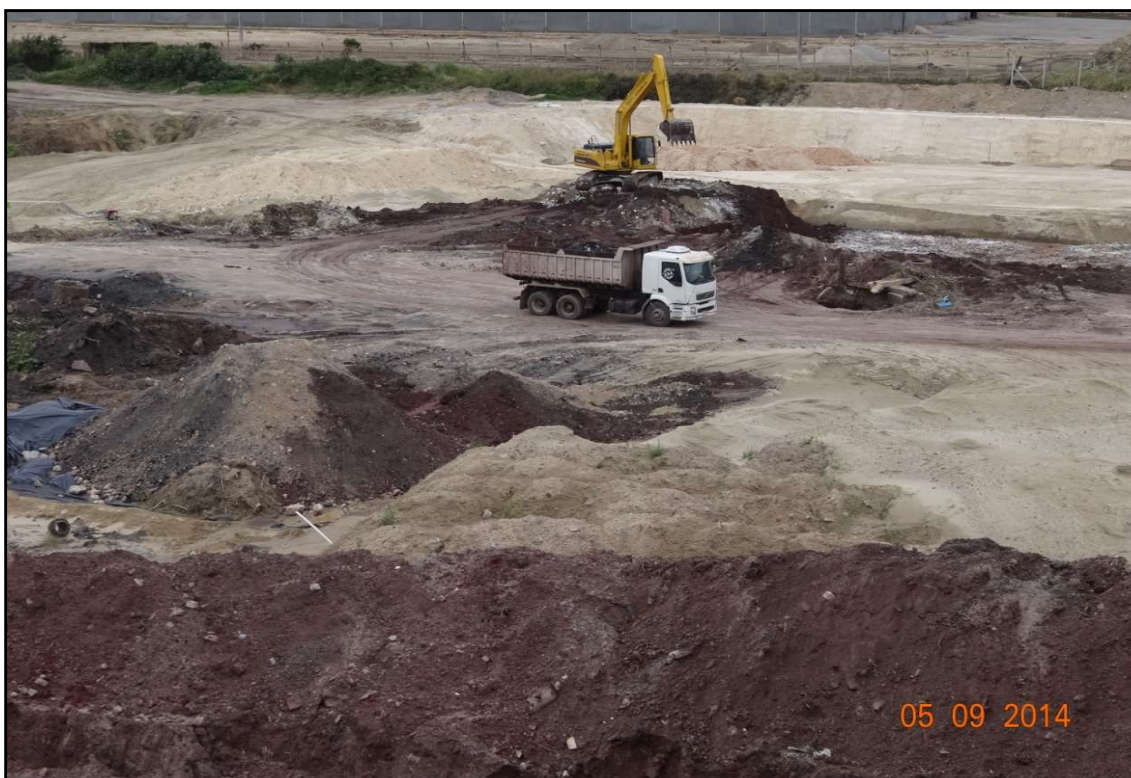
Foto 75: Visão para norte do Depósito tecnogênico (Estação 1), no Porto de Imbituba, município de Imbituba.
