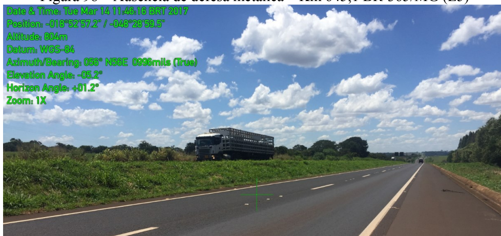
Figura 98 – Ausência de defesa metálica – Km 645,1 BR-365/MG (L5)
