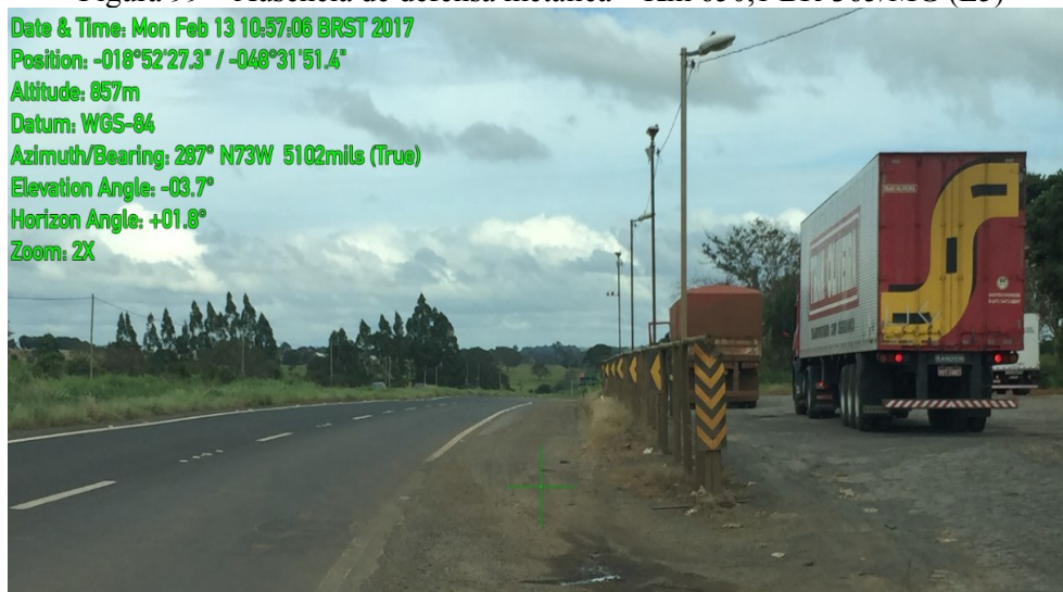
Figura 99 – Ausência de defesa metálica – Km 650,1 BR-365/MG (L5)
