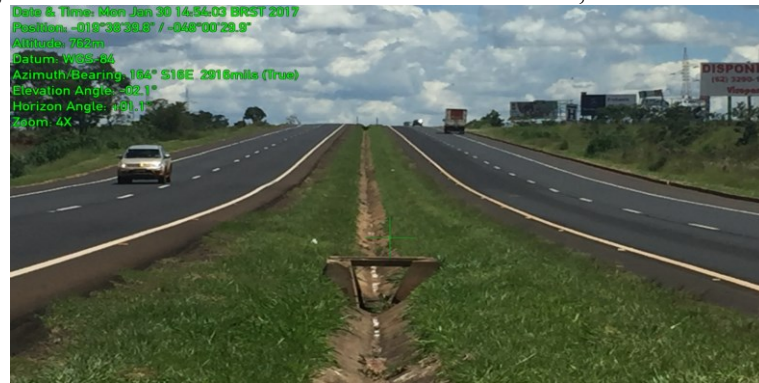
Figura 64 – Ausência de defesa metálica – Km 159,4 BR-050/MG (L5)
