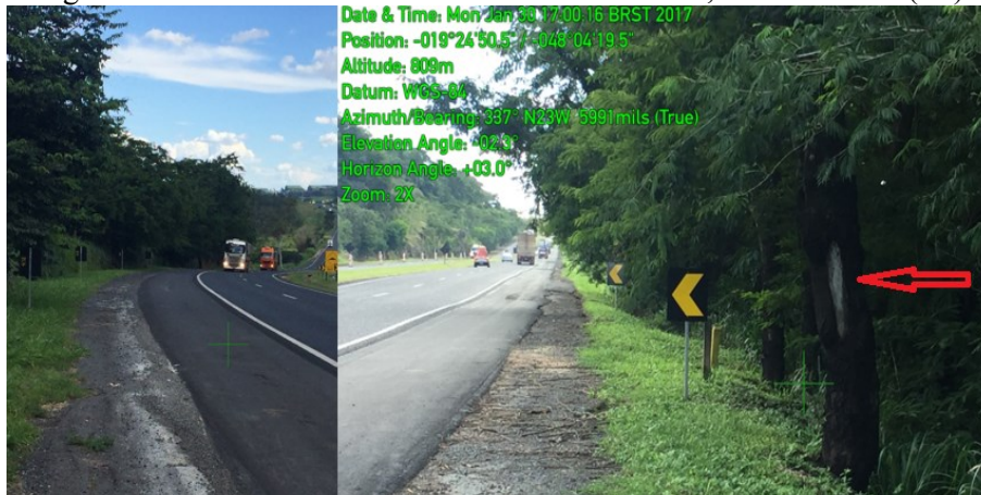
Figura 62 – Ausência de defesa metálica – Km 132,8 BR-050/MG (L5)
