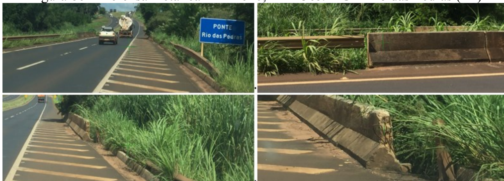
Figura 86 – Defesa metálica – Km 640,1 BR-365/MG – Rio das Pedras (L2)
