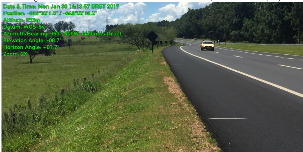
Figura 59 – Ausência de defesa metálica – Km 146,6 BR-050/MG (L5)
