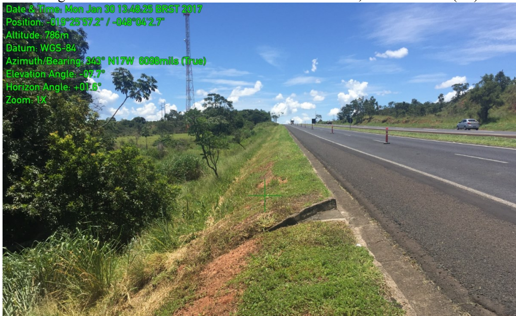
Figura 58 – Ausência de defesa metálica – Km 134,9 BR-050/MG (L5)
