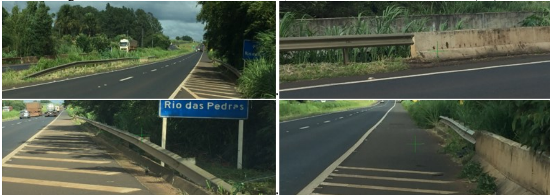
Figura 84 – Defesa metálica – Km 640,1 BR-365/MG – Rio das Pedras (L2)
