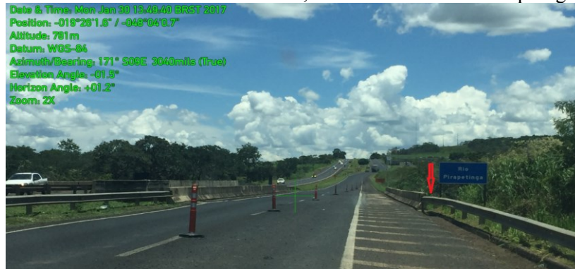
Figura 68 – Defesa metálica – Km 135,2 BR-050/MG – Rio Pirapitinga (L2)
