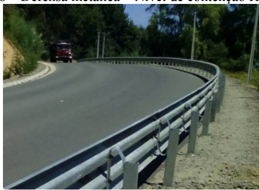
Figura 8 – Defesa metálica – Nível de contenção H2 (Alta).
