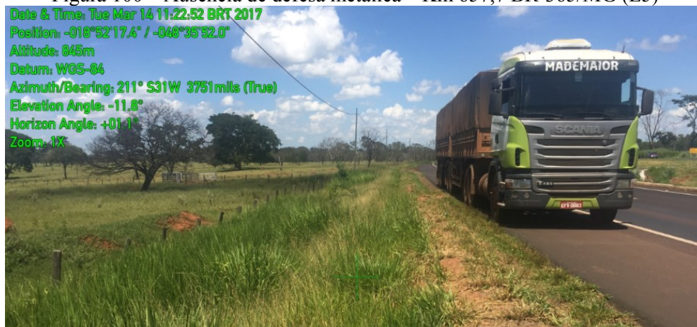
Figura 100 – Ausência de defesa metálica – Km 657,7 BR-365/MG (L5)
