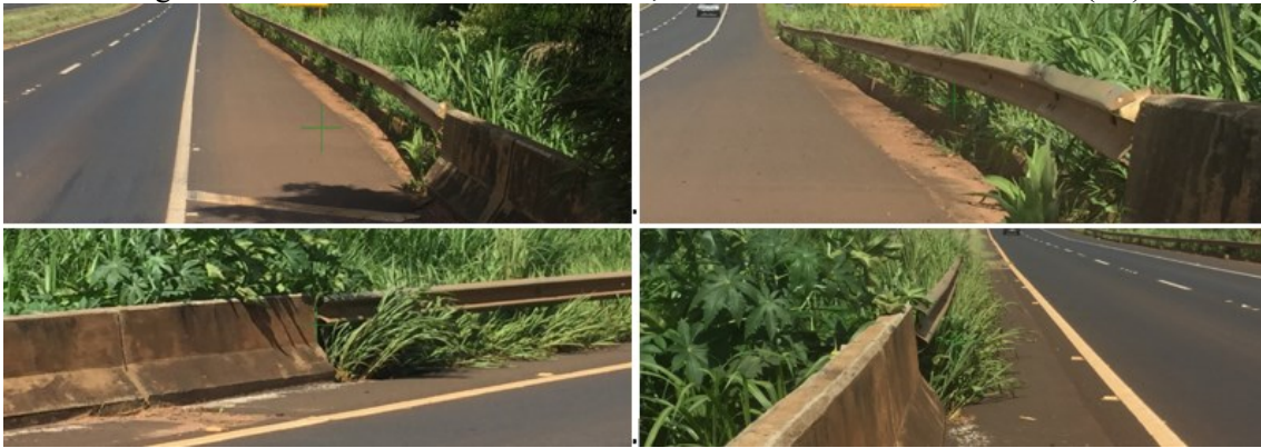
Figura 85 – Defesa metálica – Km 640,1 BR-365/MG – Rio das Pedras (L2)
