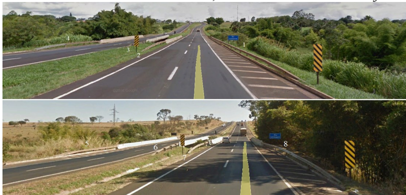
Figura 71 – Defesa metálica – Km 156,2 BR-050/MG – Rio Laranjeiras (L2)
