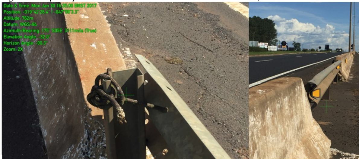
Figura 1 – Implantação em desconformidade - Defesa metálica km 166,82 – BR-050
