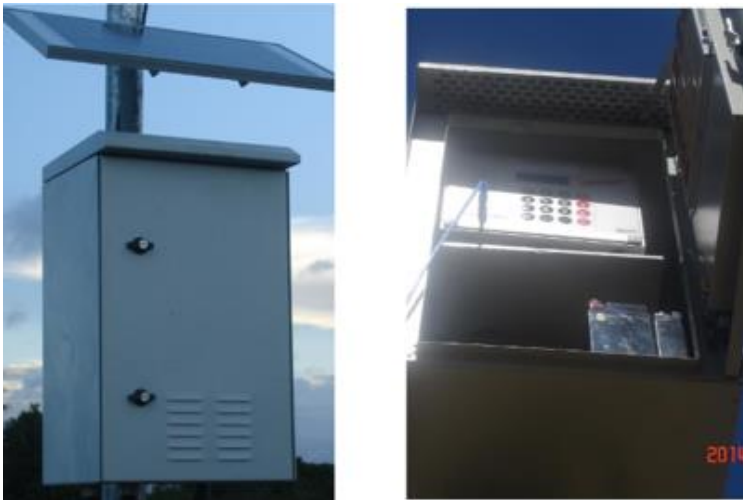
Figura 15 - Equipamento do Posto 40087 - Gabinete
