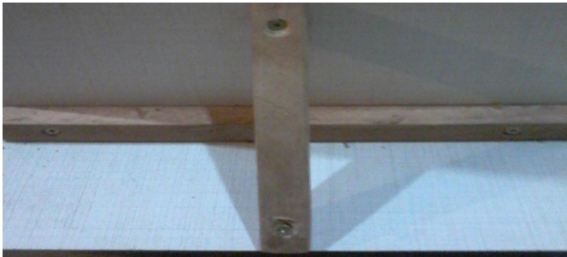
Figura 11: Escora anexada entre as placas A e B. Fonte: Arquivo da Autora.
