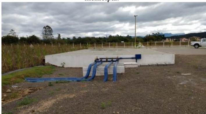
Figura 17. Vista do RAC seguido de WCV implantado em sistema municipal.
