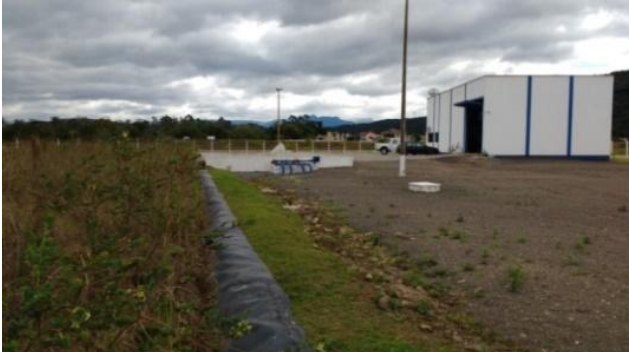
Figura 18. Vista do wetland com impermeabilização e plantado com Typha sp.
