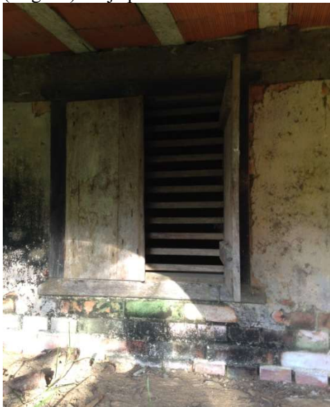
Figura 54 - Janela do porão em madeira (original) e laje pré-moldada na varanda
