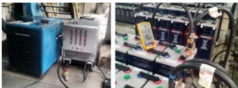
Figura 40. Banco de resistências e teste de capacidade para banco de +24Vcc.
