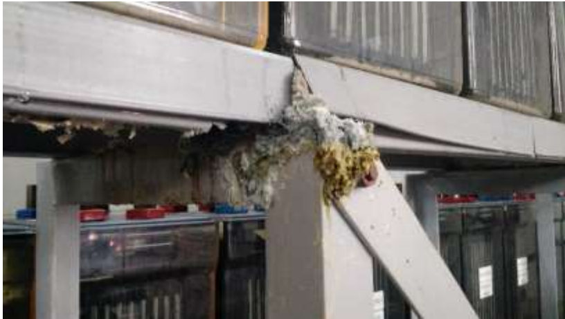
Figura 42. Danos no rack de sustentação devido ao vazamento de eletrólito em uma célula com trinca.
