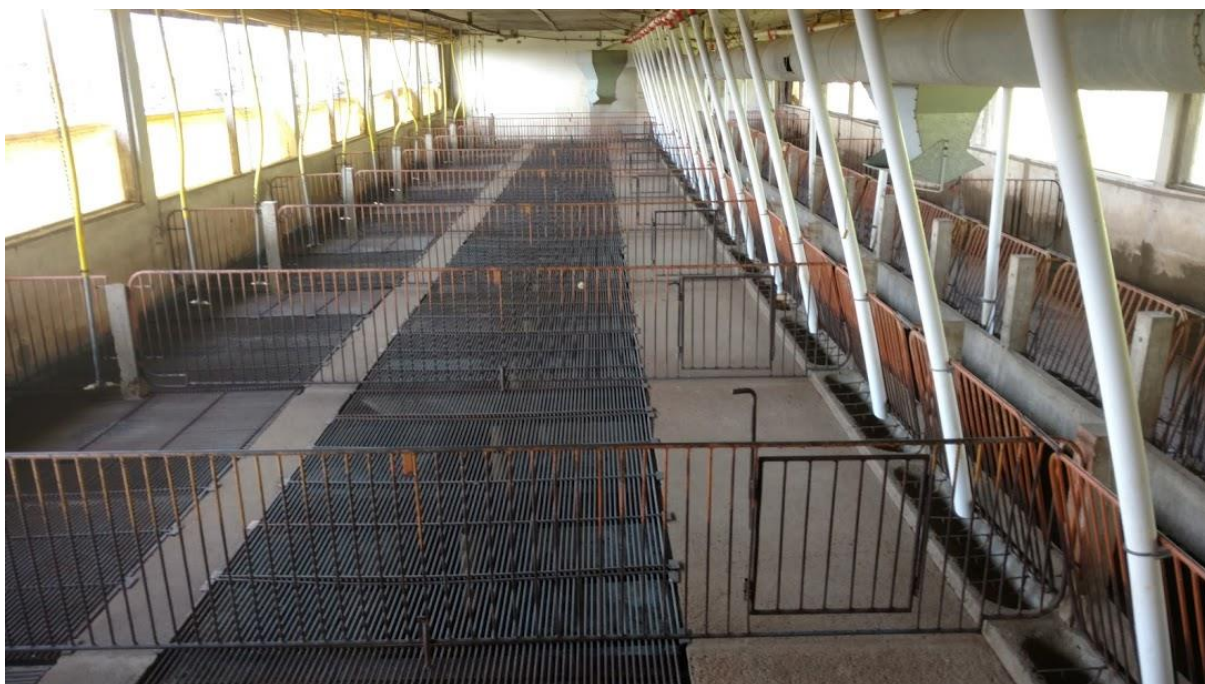
Figura 12: Sala da creche pronta para receber leitões do desmame.
