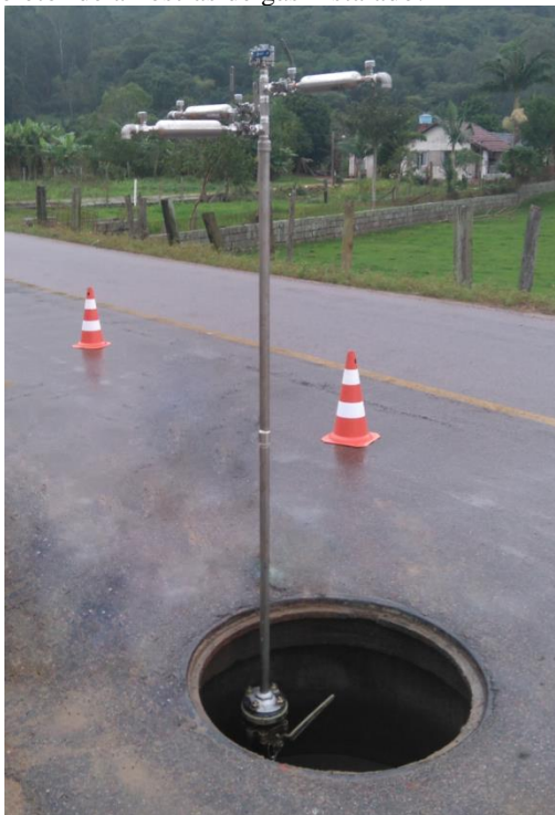
Figura 5.4 - Coletor de amostras de gás instalado.
