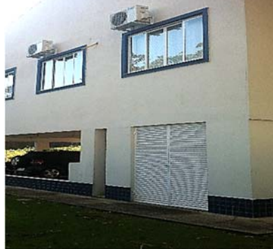
Figura 19 - Sala compressor e gramado
