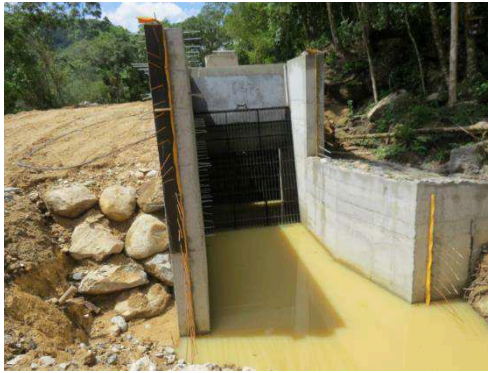
Figura 11 – Tomada de Água da CGH Médio Garcia
