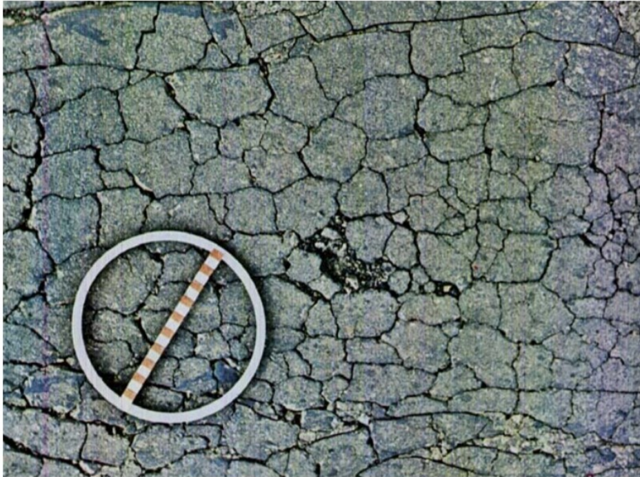
Figura 7 - Trinca interligada tipo "jacaré"
