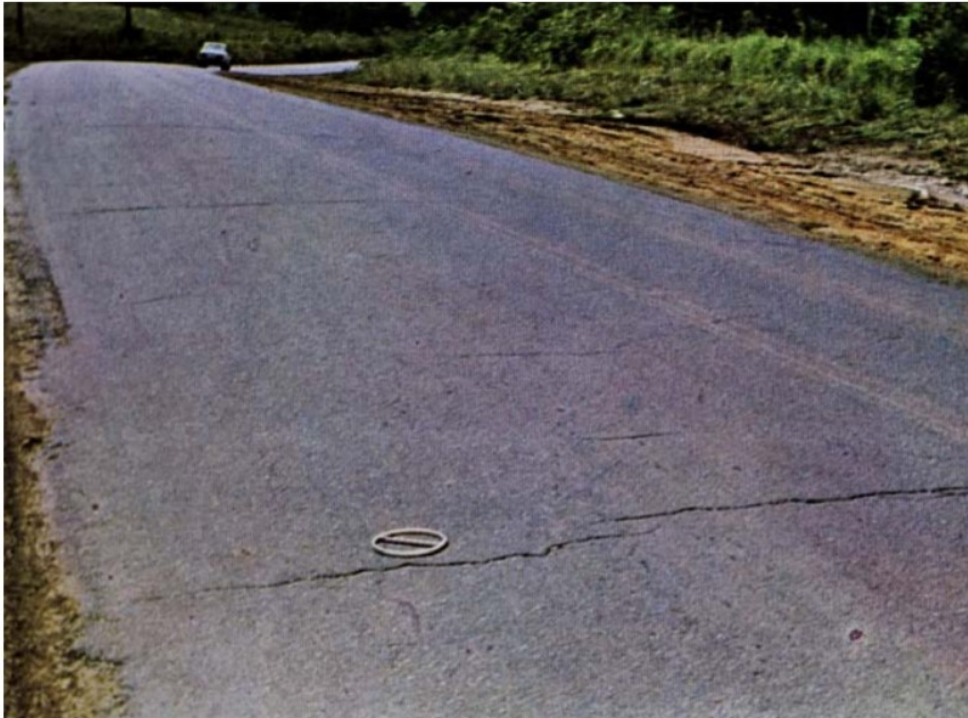
Figura 5 - Trinca isolada transversal
