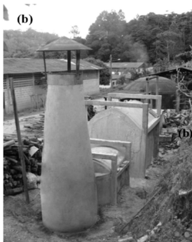
Figura 15. Detalhe da fornalha de combustão.
