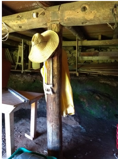
Figura 7: Porão de uma casa, com chão batido.
