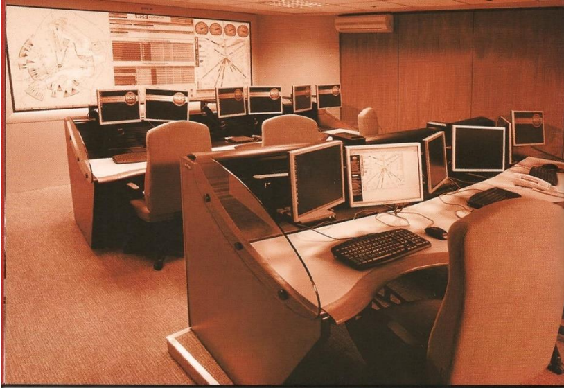
Figura 77 - Centro de Comando e Controle.
