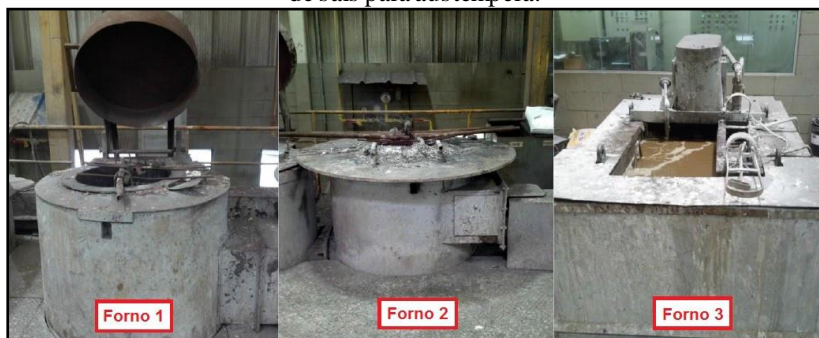
Figura 3.3 – Fornos utilizados para o tratamento térmico. (1) forno elétrico para pré-aquecimento, (2) forno elétrico para austenitização e (3) forno combanhos de sais para austêmpera.
