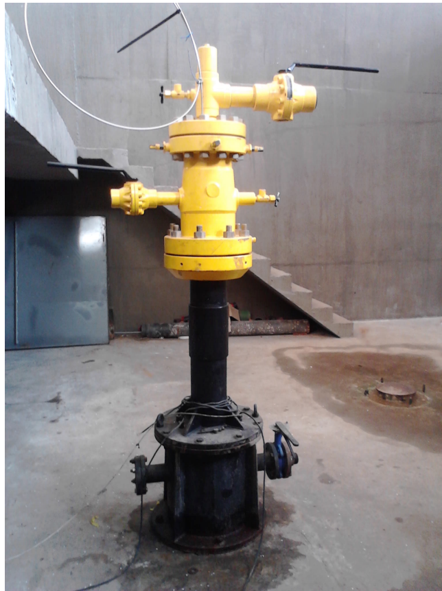
Figura 4.16: Poço número 1 do LACI foi completado com revestimento, tubo de produção, cabeça de poço e sensores de fundo de poço.
