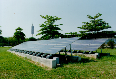
Figura 12 – Exemplo de um arranjo de painéis fotovoltaicos.
