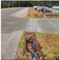
Ilustra o reaterro de vala, passagem do cabo de aterramento e proteção mecânica no trecho N do projeto de Iluminação Externa;
