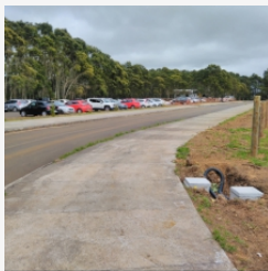
Ilustra caixas de passagem no trecho X e execução do aterramento de valas;
