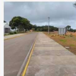
Ilustra o reaterro em valas após execução das infraestruturas previstas no trecho C do projeto de Iluminação externa, concluindo o perímetro do anel viário do Campus de Curitibanos.
