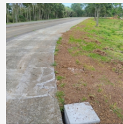
Fotografia ilustrando a execução de caixas de passagens e o reaterro de valas no trecho C previsto no projeto de Iluminação Externa;
