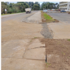
Idem fotografia anterior ilustrando continuidade do trecho C e corte no pavimento asfáltico;
