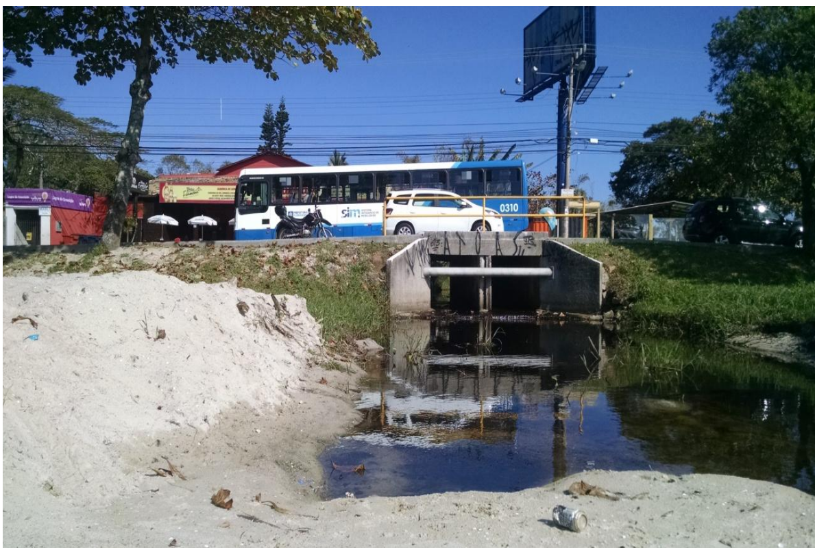
Figura 41 - Sistema ambiental canais de drenagem da Lagoa da Conceição. Fonte: Foto do autor.
