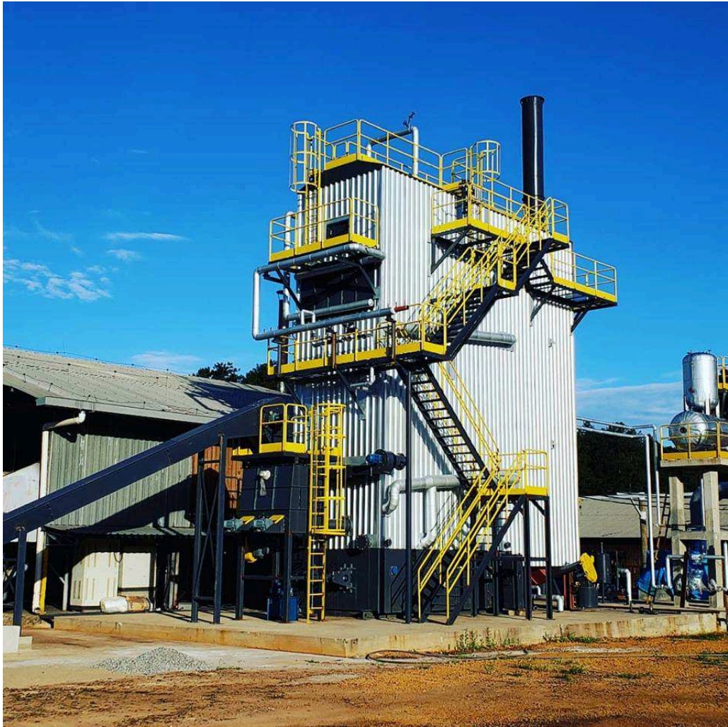
Figura 1 – Caldeira Flamotubular MGV-8000 instalada na Fazenda Agrotec em Catalão-GO
