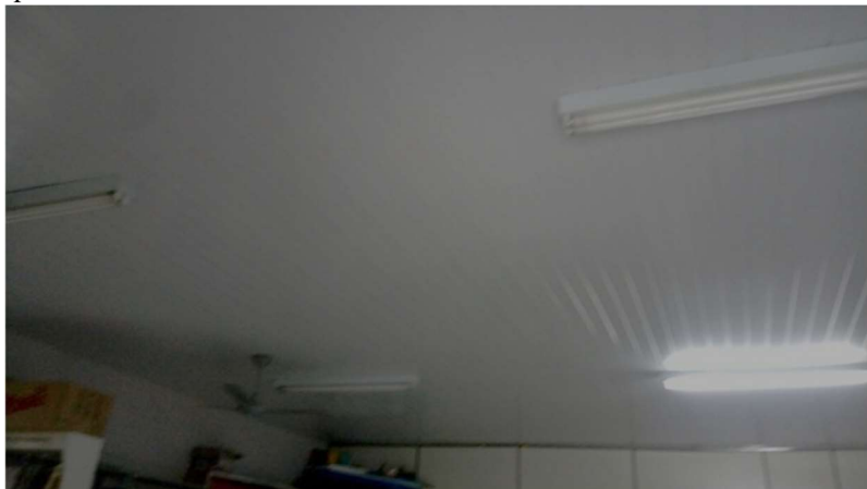
Figura 1: Iluminação precária da biblioteca, com várias lâmpadas queimadas
