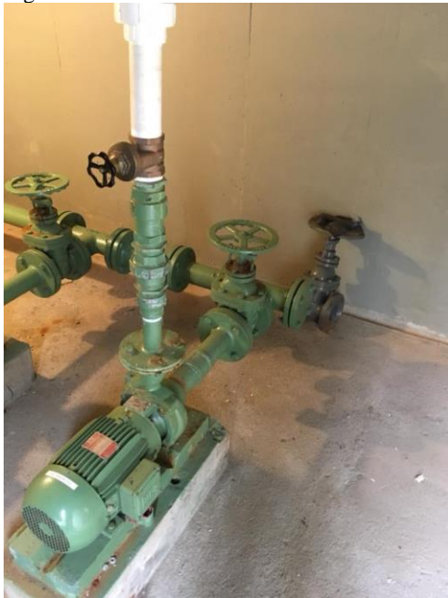
Figura 20 - Sistema de bombeamento do reservatório superior
