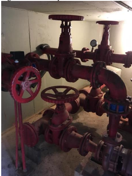
Figura 21 - Instalações hidráulicas referentes ao sistema preventivo de incêndio
