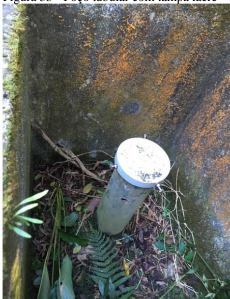
Figura 33 - Poço tubular com tampa lacre
