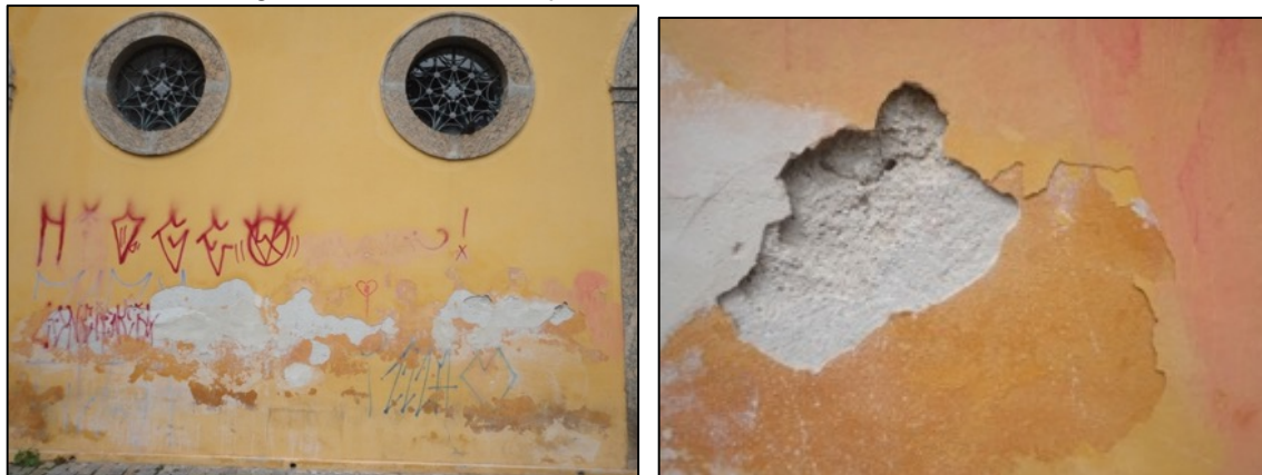
Figura 43 – Paredes do patrimônio histórico sem manutenção.
