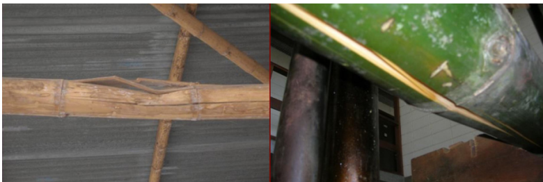
Figura 11: Falha do colmo: (A) por esmagamento; (B) por fendilhamento.
