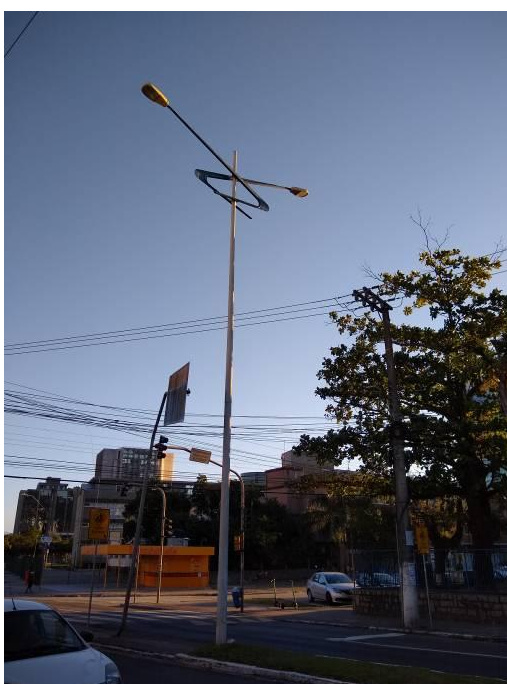
Figura 71 - Poste de iluminação no canteiro central
