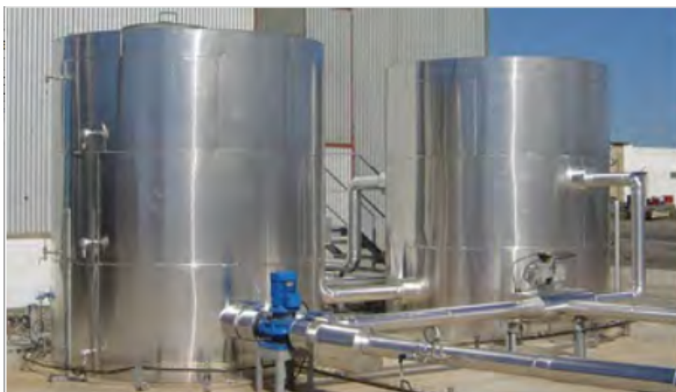
Figura 7 – Foto dos tanques quente e frio
