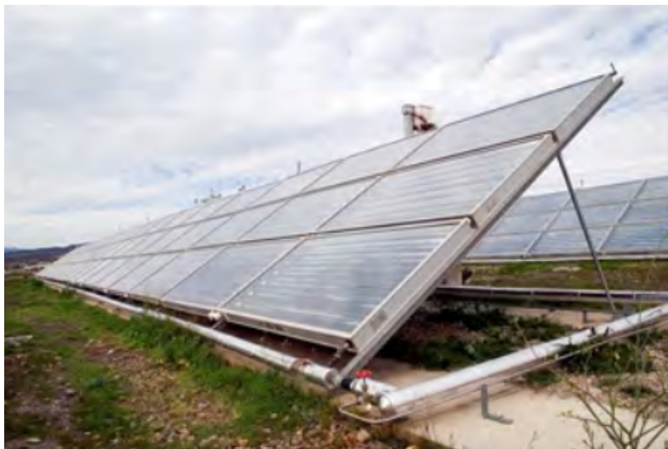
Figura 6 – Foto dos painéis solares
