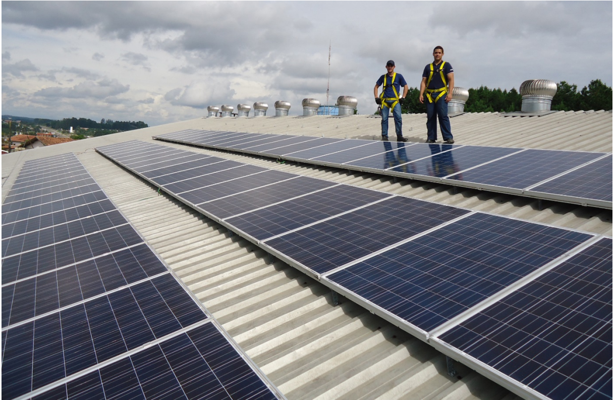
Figura 12 - Usina fotovoltaica instalada na empresa Proengel
