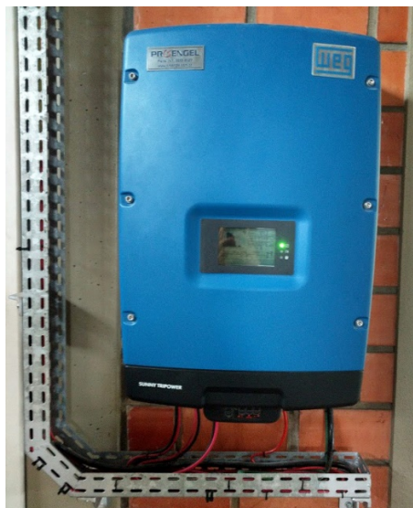
Figura 10 - Inversor SMA Sunny Tripower STP 12000 TL-20 instalado na empresa.
