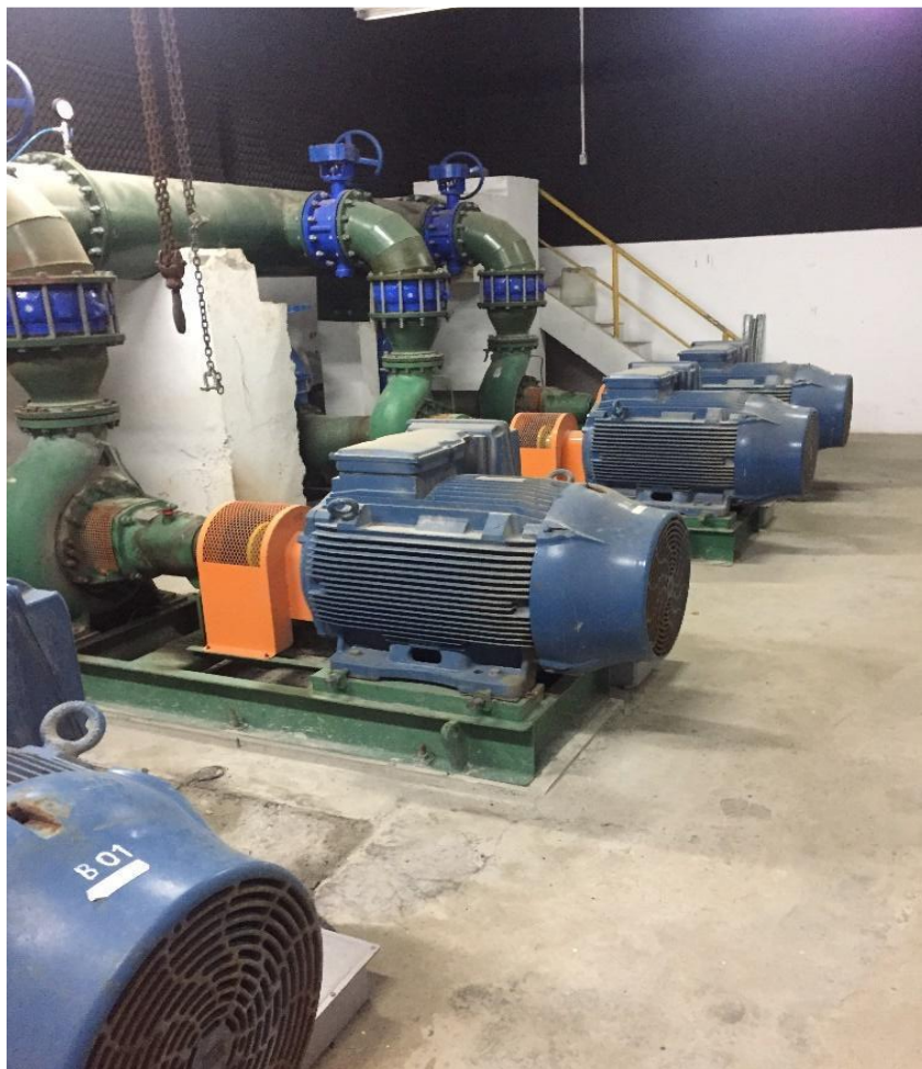
Figura 5 - Bombas ERAT Ingleses.
