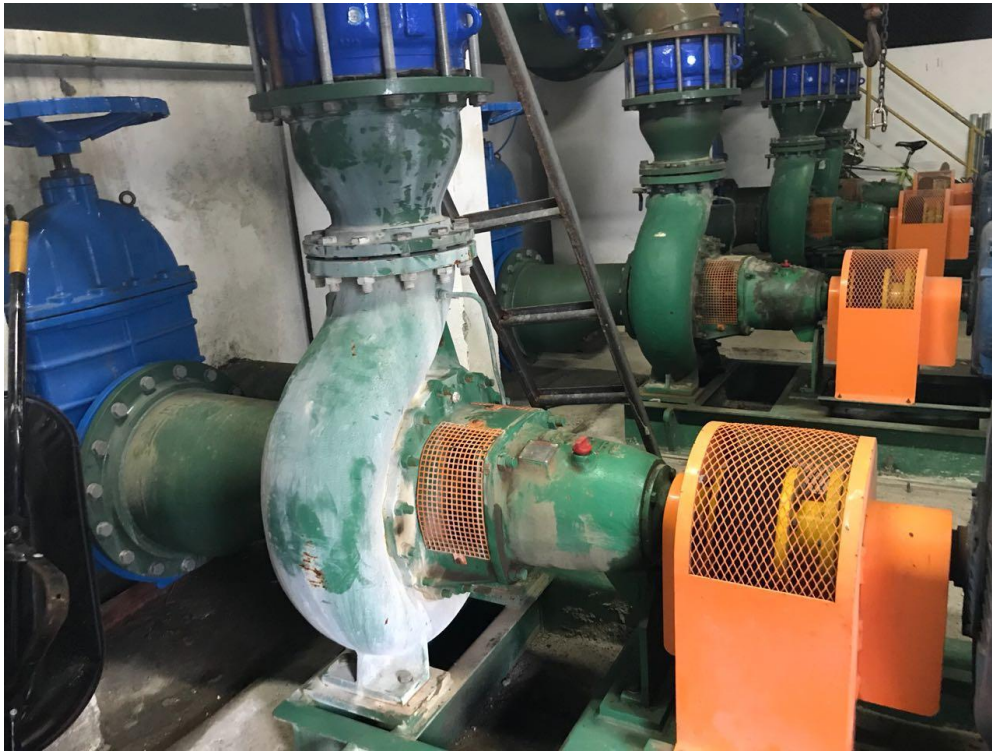
Figura 37 - Bombas ERAT Ingleses.
