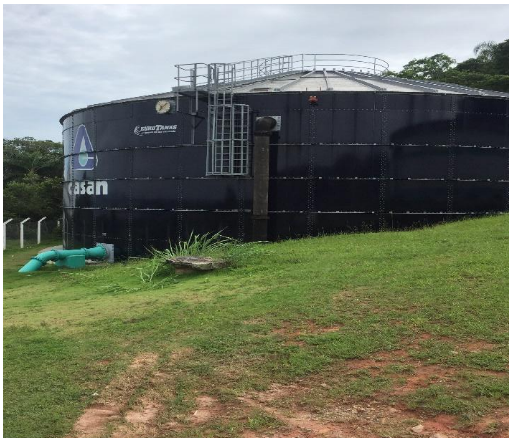
Figura 9 - Tanque 1000m 3 Reservatório Cachoeira.
