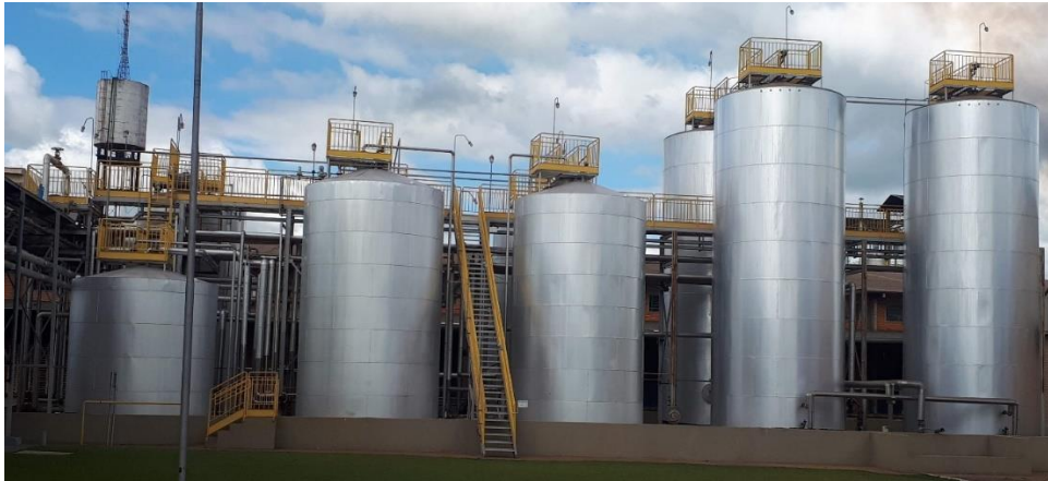
Figura 10 – Armazenagem de óleo e gorduras no parque de tanques. Fonte: original.
