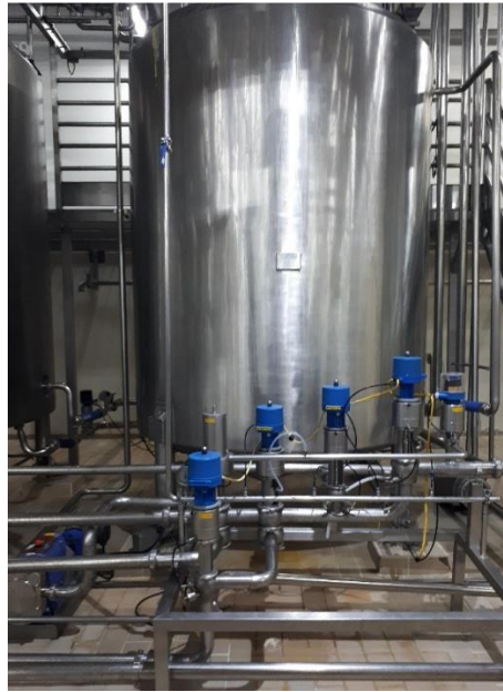
Figura 11 – Saída do tanque de emulsão (51). Fonte: original.
