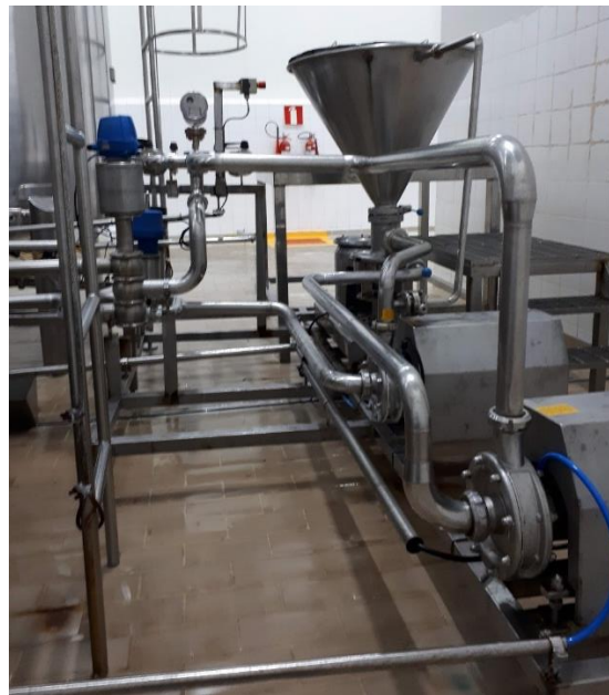
Figura 5 – Bombas, válvulas e dosador de sal dos tanques de salmoura. Fonte: original.
