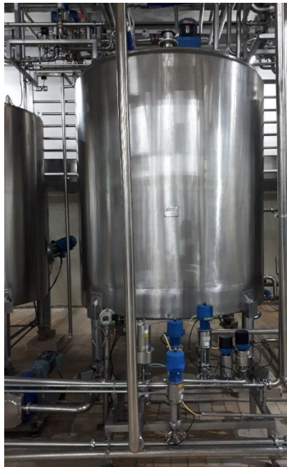
Figura 12 – Saída do tanque pulmão (61) para o envase. Fonte: original.
