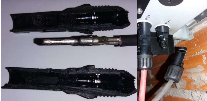
Figura 12 – Conectores MC4 que ocasionaram a falha do SFCR de Meleiro/Sapiranga.
