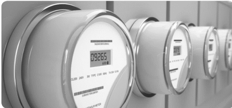
Figura 8 - Exemplo de Smart Meter instalado.
