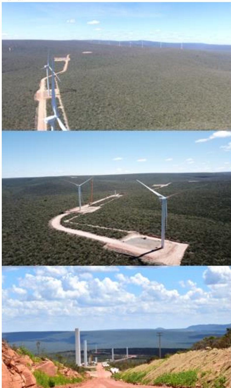
Figura 10 – Montagem dos aerogeradores do Complexo Eólico Campo Largo localizado no norte do estado da Bahia.
