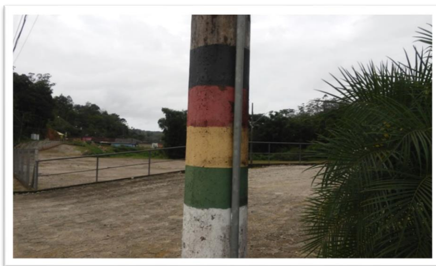
Figura 04 - Poste de energia elétrica de Santa Teresa
