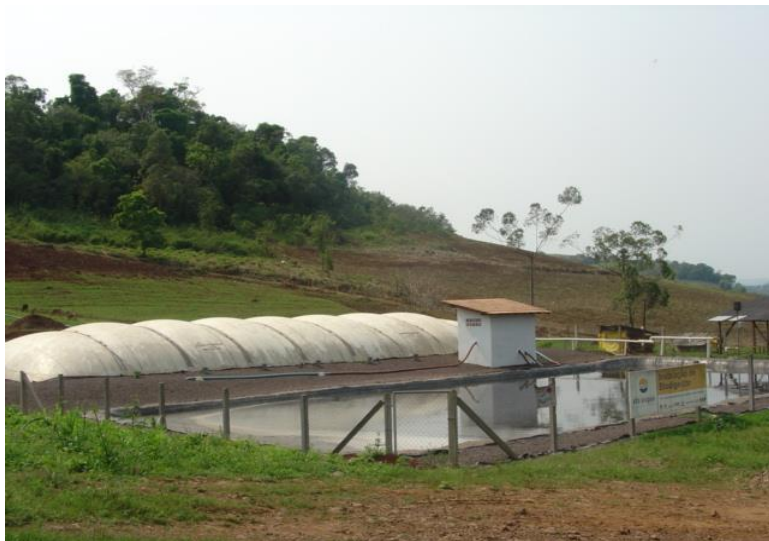
Figura 08 – Biodigestor instalado pelo “Projeto Alto Uruguai” no município de Itapiranga.
