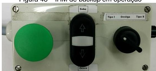
Figura 48 – IHM de backup em operação
