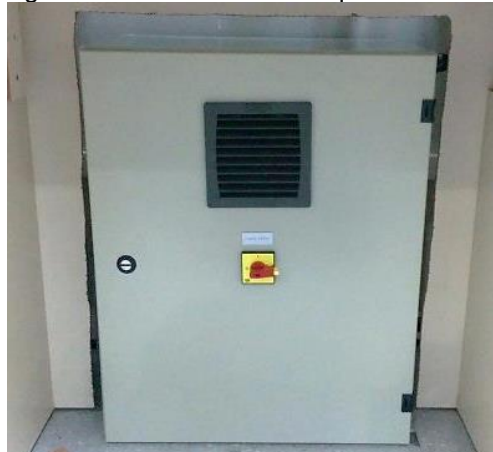
Figura 50 – Vista frontal do quadro elétrico
