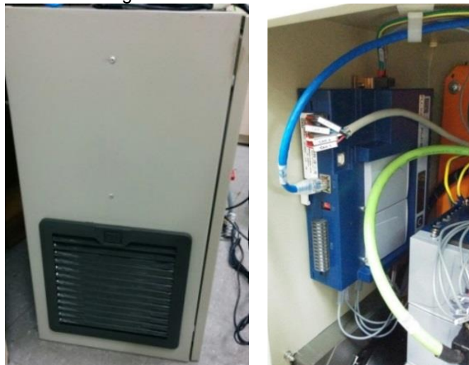
Figura 49 – PLC300 no sistema
