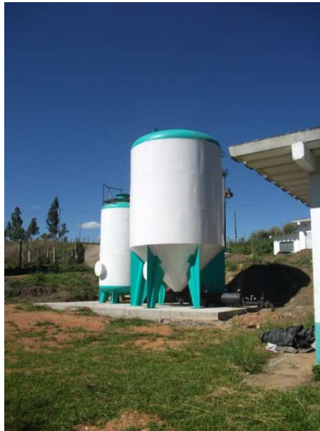
Figura 3: Uma das três ETA's compactas da CASAN, trata a água dos mananciais do Rio das Pombas e do Poço JB952, Município de Correia Pinto - SC.
