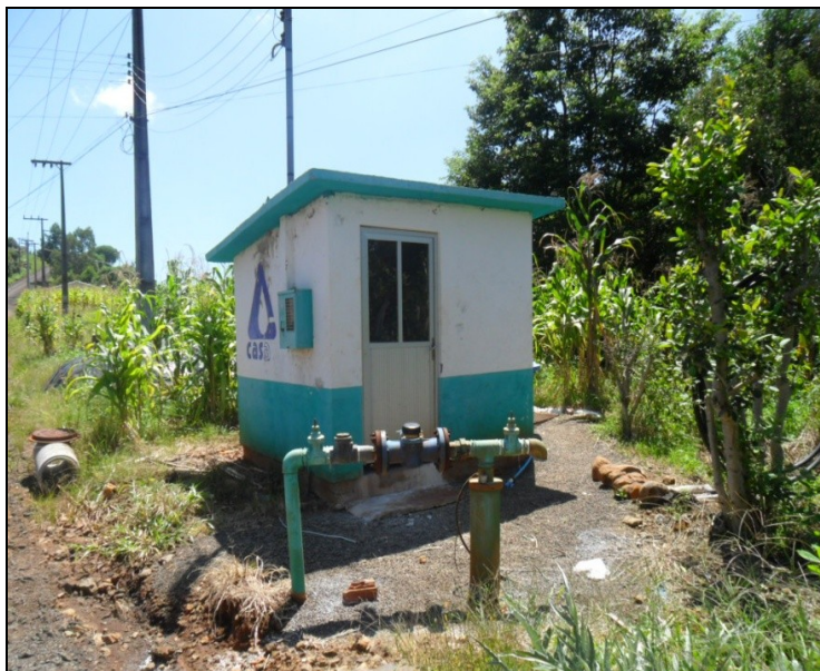
Foto 16: Localização poço profundo N°. 16 – Vargem Bonita/SC.
