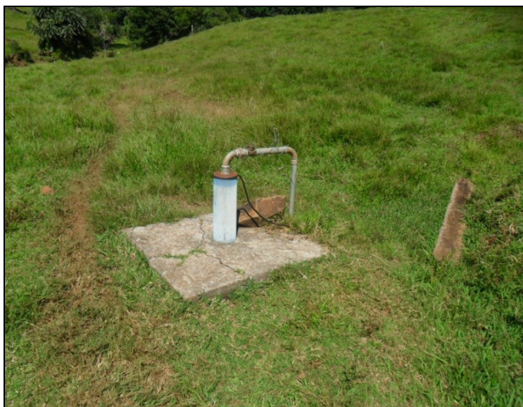
Foto 05:Localização poço profundo N°. 05 – Concórdia/SC.
