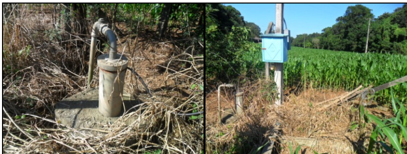
Figura 38: Poço N o . 8, em área rural, cercado por cultivo de milho e granjas de suínos. A manutenção inclui o secamento químico da vegetação do entorno.
