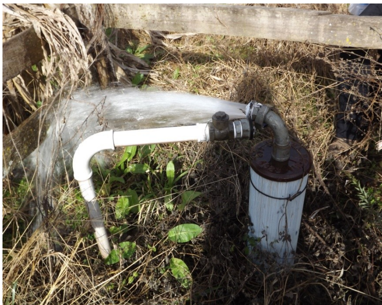
Foto 21: Localização poço profundo N° 21 – Concórdia/SC
