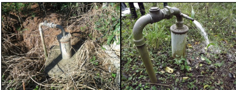
Figura 48: Pontos de Coleta das Amostras 08 e 22 – ausência de proteção. Fonte: Acervo pessoal da autora
