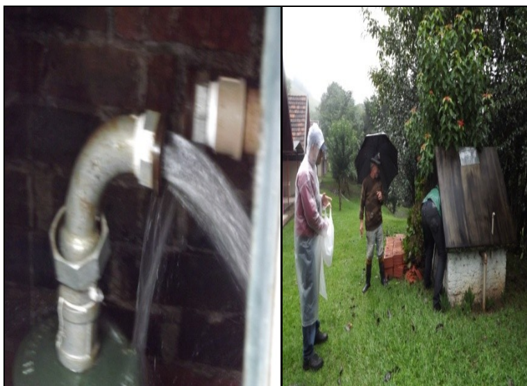
Foto 13: Localização poço profundo N o . 13 – Arabutã/SC.
