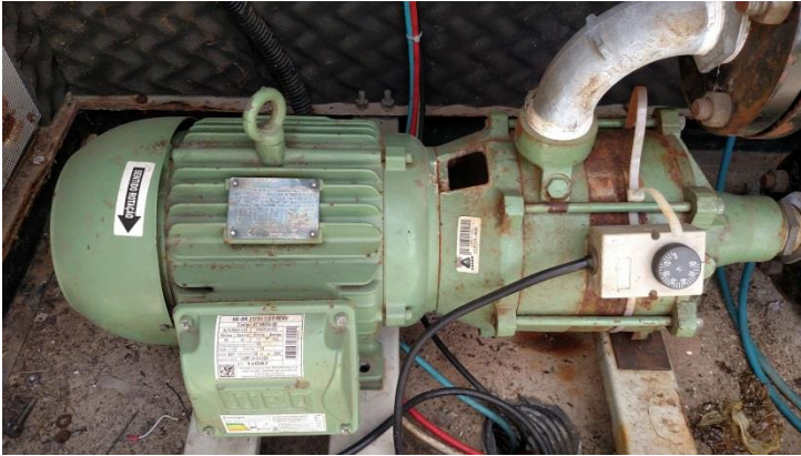
Figura 28: Moto-Bomba booster Fortaleza da Barra
