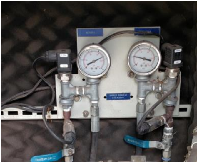
Figura 24: Barrilete de medição de pressão do Booster Fortaleza da Barra
