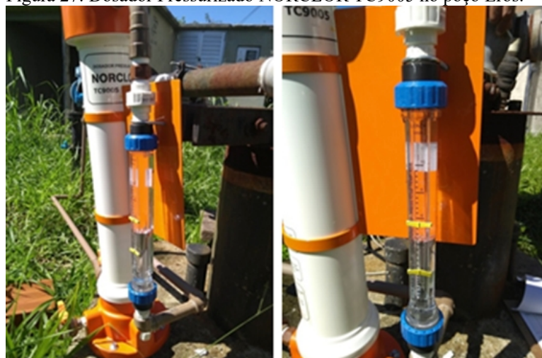
Figura 27: Dosador Pressurizado NORCLOR TC9005 no poço Eros.
