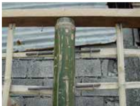
Figura 7: Detalhe dos “pregos” de madeira unindo as lascas do tramado a estrutura em bambu roliço. Fonte: Ubidia, 2015.
