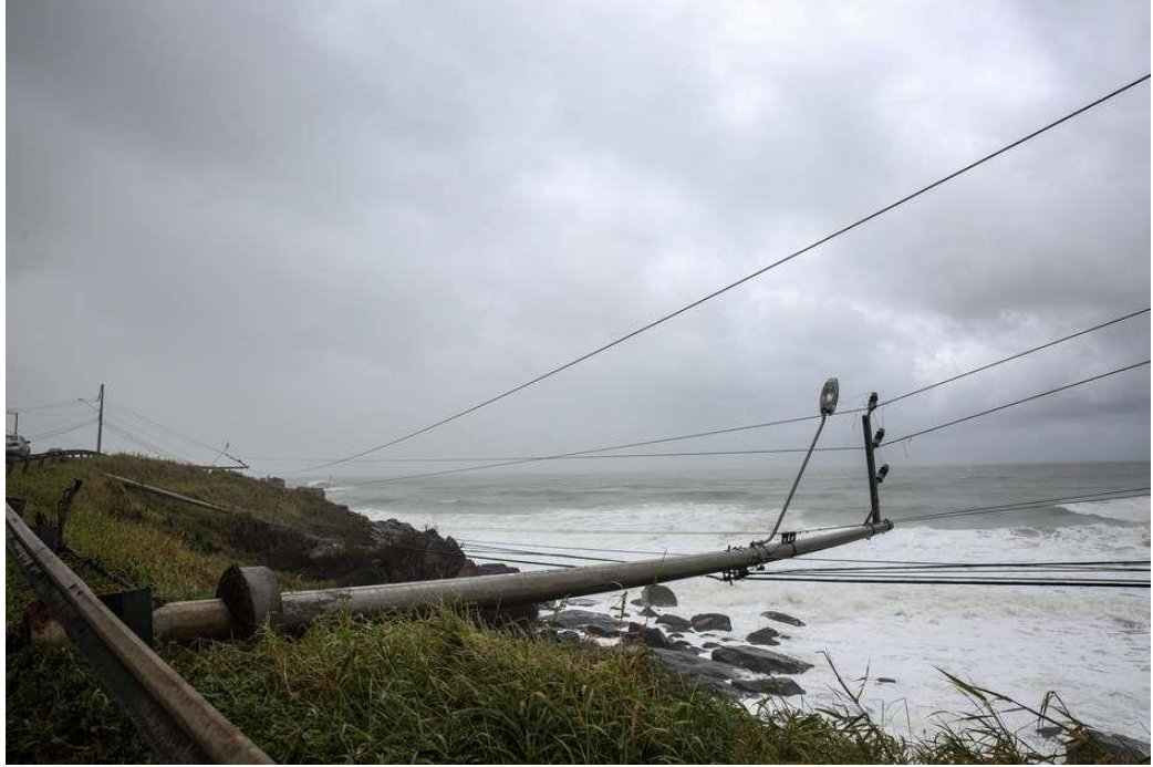
Figura 23 – Poste caído próximo ao mar, no bairro do Morro das Pedras (sul da ilha). Fonte: Portal Terra, 2016.
