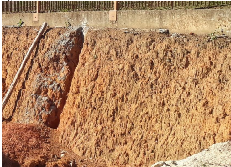
Figura 5 - Alteritos em corte de encosta
