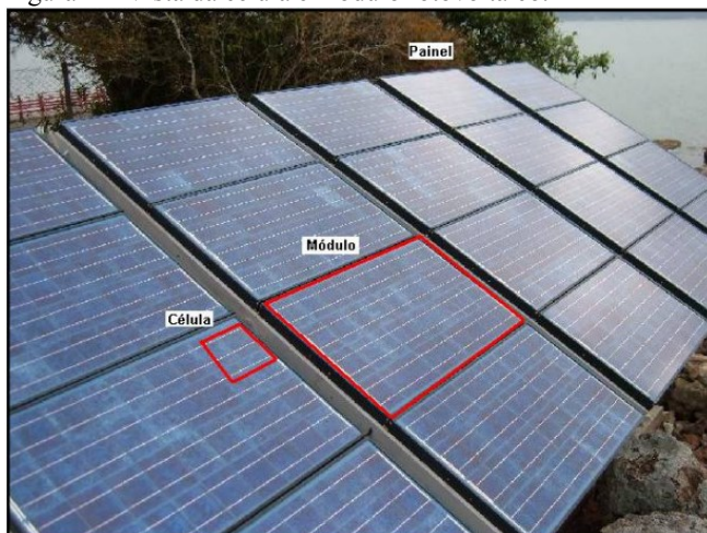
Figura 2 – Vista da célula e módulo fotovoltaico.
