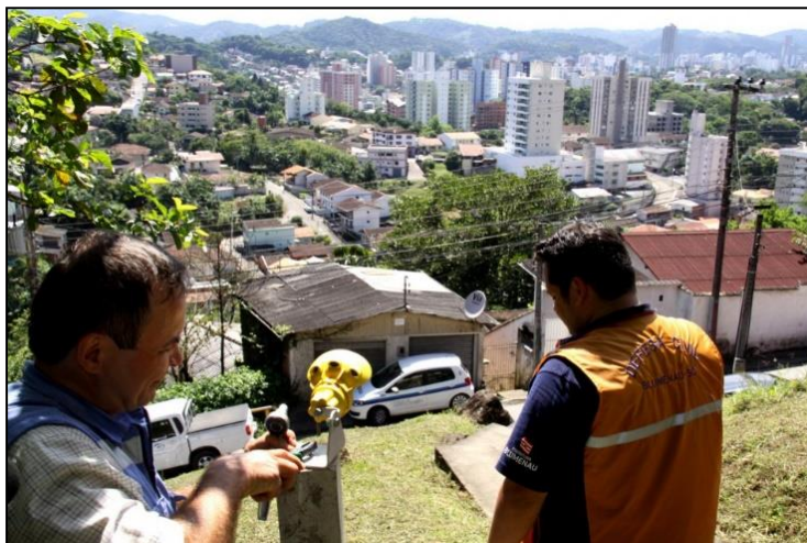
Figura 13 - Instalação dos prismas por técnicos do CEMADEN e Defesa Civil de Blumenau.
