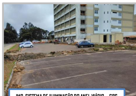
IMP. SISTEMA DE ILUMINAÇÃO DO ANEL VIÁRIO - CBS
